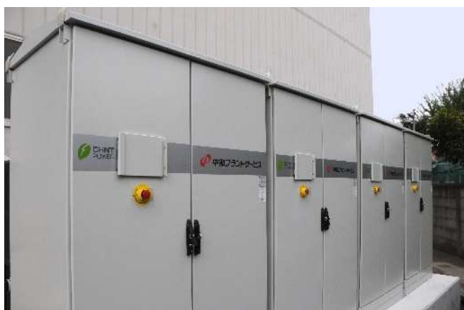
【リチウムイオン蓄電池】
