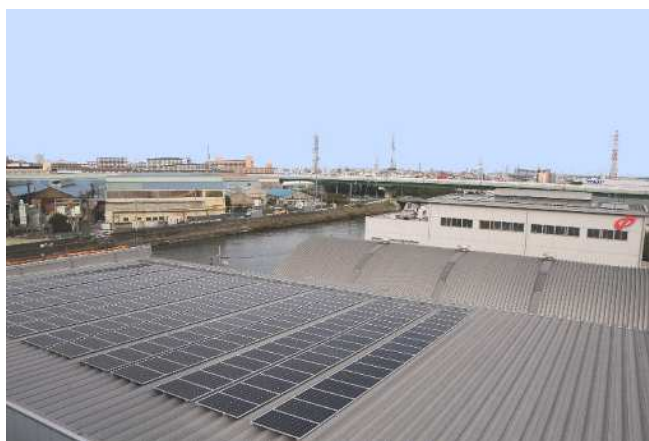
【太陽光パネル】
