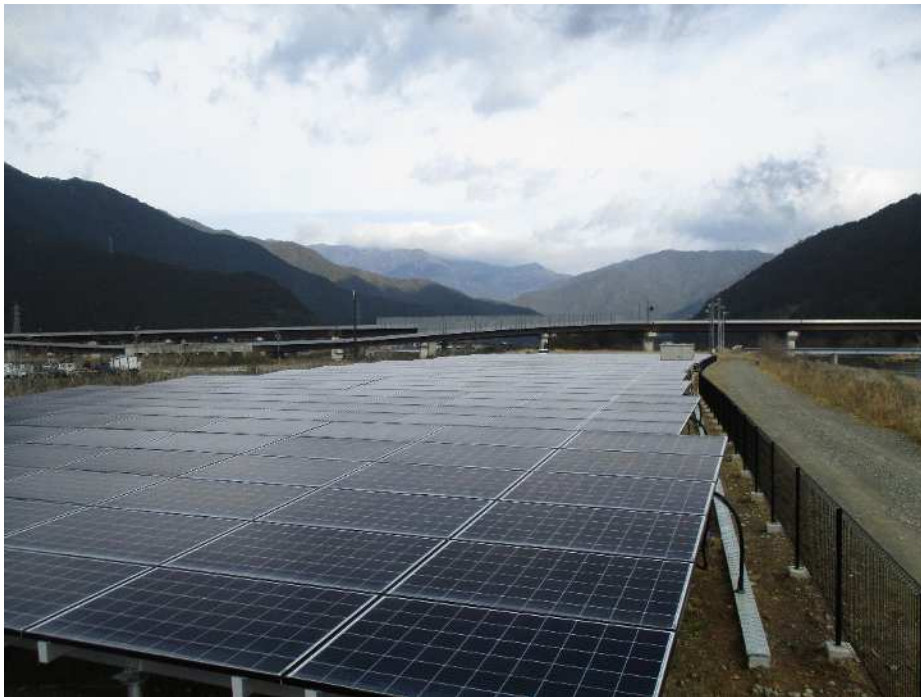
約4,400㎡の土地に1,560枚のパネルが並ぶ、三重県海山太陽光発電所
